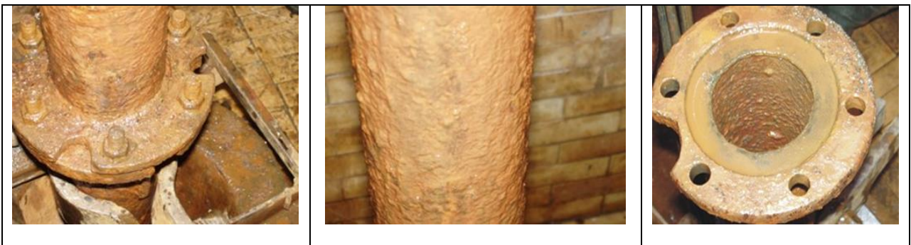
Рис. 1. Биообрастания на наружной и внутренней поверхности водоподъемных труб скважин
