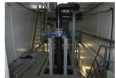
Камера смешения с циркуляционными насосами
