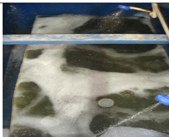
Рис. 4. Процесс очистки сточных вод во флотационной камере (2-я ступень очистки).
