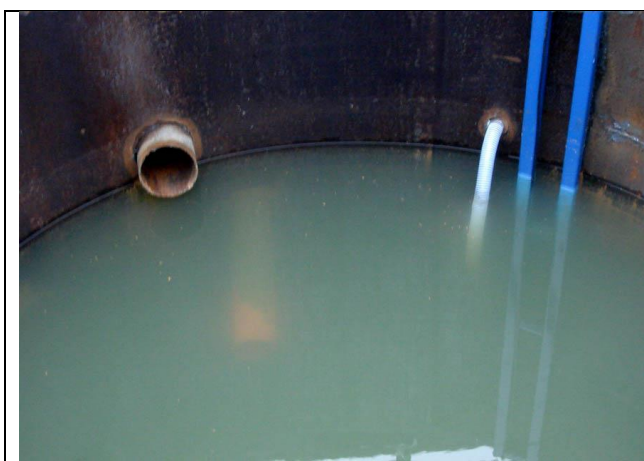
Рис. 5. Качество поступающей на очистку воды. Приёмник-усреднитель стоков.
