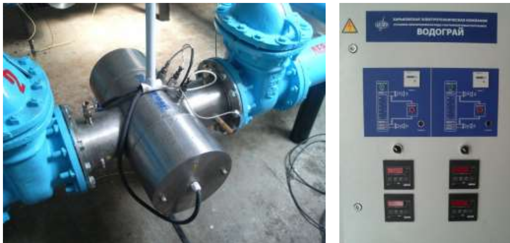
Рис.1. УФ установка з УФ лампами середнього тиску. Продуктивність 200 м 3 /годину, потужність 8 кВт. Питомі витрати електроенергії – 40 Вт/м 3 . Насосна станція «Ленінська», КП «Кривбасводопостач», м. Кривий Ріг.
