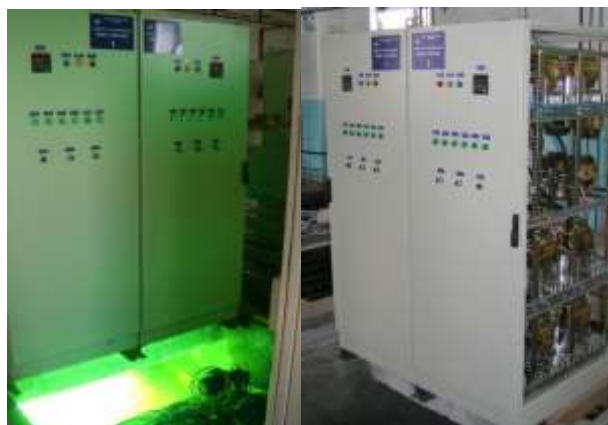
Рис. 10. Шафи ПРА для живлення УФ ламп, які встановлені у касетах В6КС.01
