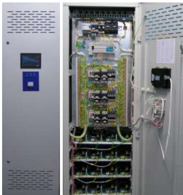
Рис. 6. Шафа управління 3В8КС.02, забезпечує одночасну роботу трьох знезаражуючих касет В8КС.01
